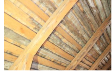
Kuva 61. Vintin kylmissä väliköissä kattorakenne näkyy hyvin. Katon korjauksen yhteydessä säilytettiin kattotiilien alla olleet päreet. Kuva nro 8044.
