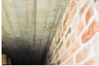
Kuva 60. Kellarin tiiliseinät ovat pääosin rappaamattomia. Entisissä pyykkituvassa, pakarissa ja saunassa seinät ovat rapatut. Välipohjana oleva alalaattapalkiston alalaatta on betonia. Kuva nro 8037.
